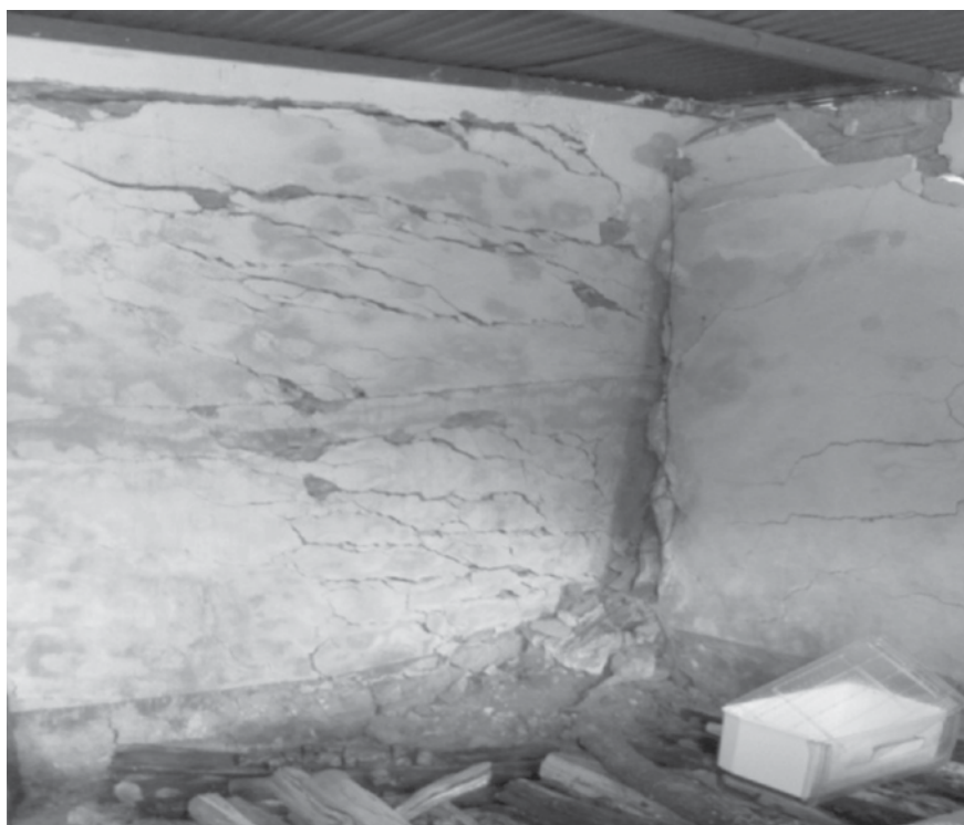
Imagen 1. Daños en una vivienda, Villa Hidalgo, Oaxaca.
