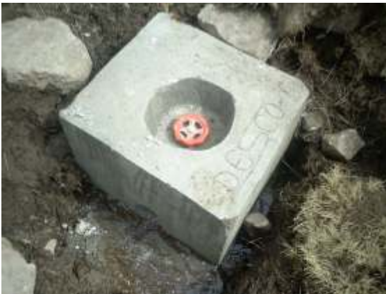
Caja de seguridad de válvula.
