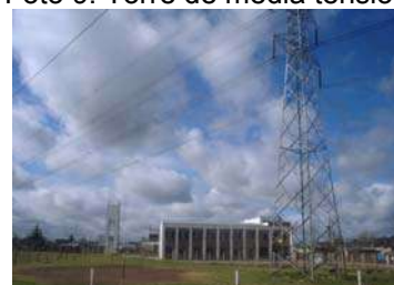
Foto 9. Torre de media tensión
