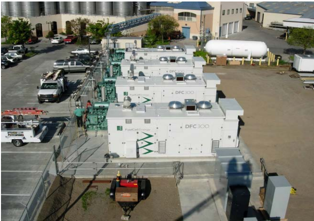
Fig. 7 Central de generación eléctrica DFC300MA
