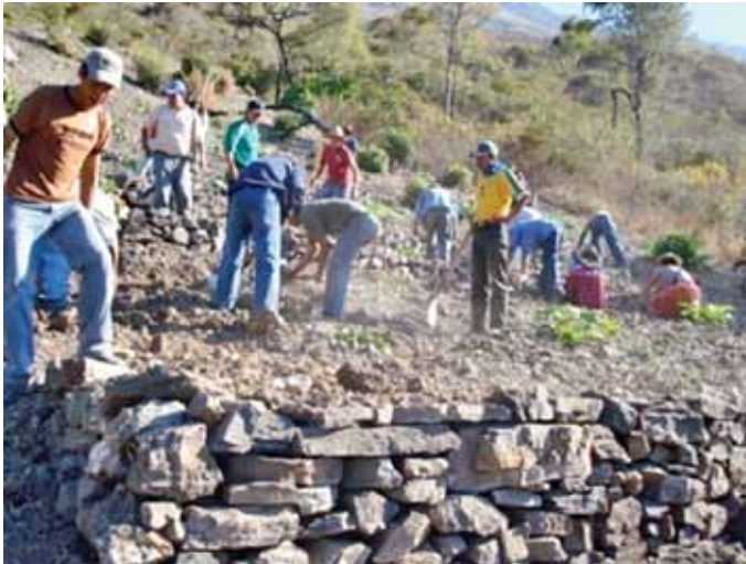
Construcción de Terrazas en la comunidad de Ch'orojo, municipio de Sipe Sipe, Provincia de Quillacollo, Departamento de Cochabamba
