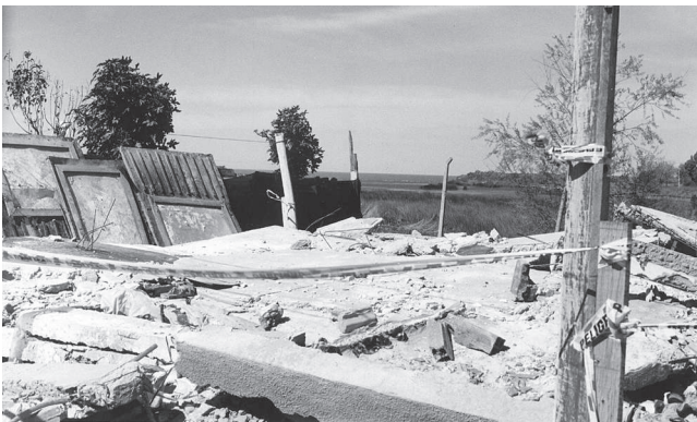
IMAGEN 7. Una casa demolida tras el desalojo parcial de la villa en 2005. En segundo plano, el Río de la Plata y la Reserva Ecológica (María Carman, 2005).
