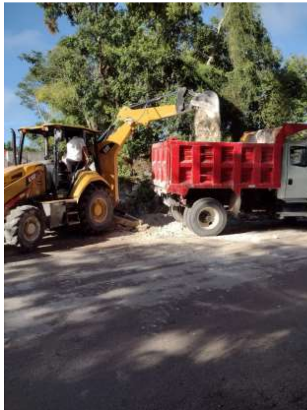
Xpujil, Campeche. Destrucción de una estructura prehispánica para la construcción de una nueva terminal de autobuses ADO. Foto. 30 nov 2021
