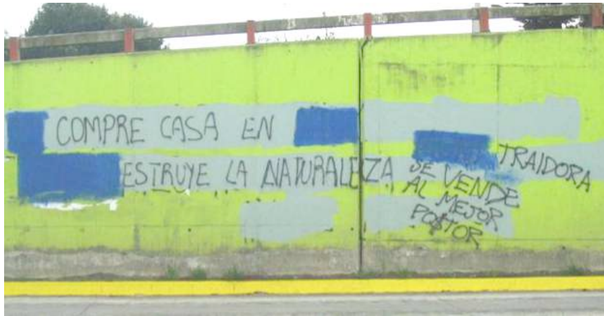
Figura 31 - Rayados sobre rayados paso nivel
