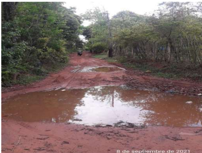
Imagen 1. Camino característico antes de lograr el asfaltado
