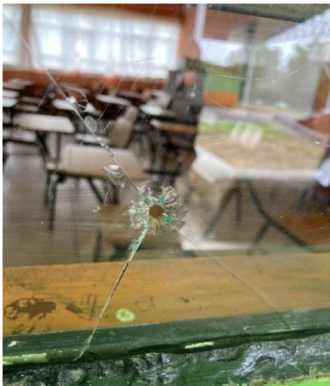
Una ventana de un aula escolar con impacto de arma de fuego. Fotografía propia (2021).
